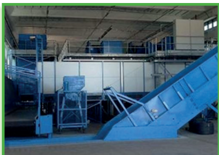
Estrattore in fossa per alimentazione di pressa
